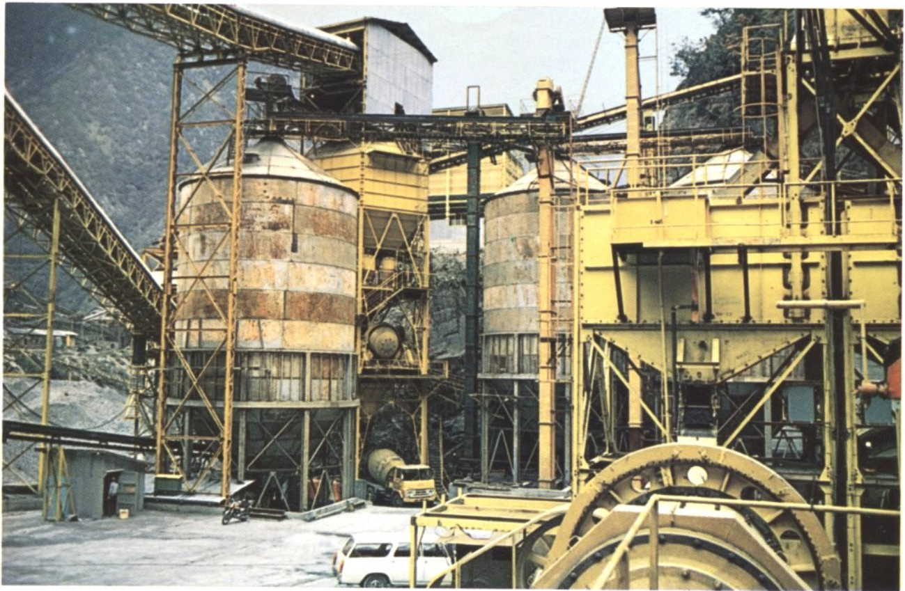
Impianto per la produzione del calcestruzzo, con una potenzialità di 130 m 3 /ora.
