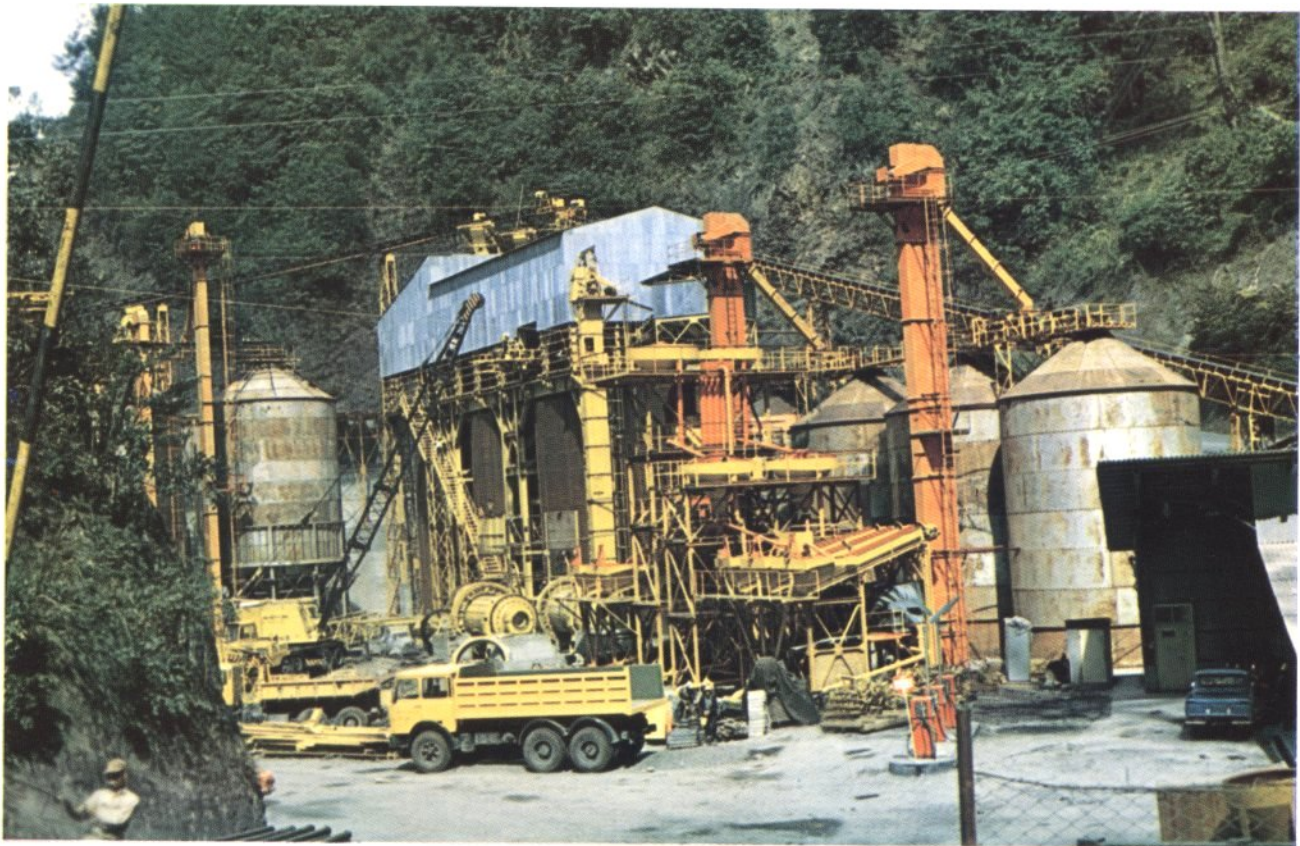
Impianto di vaglio lavatura e trattamento sabbie, produzione oraria 460 t/ora.
