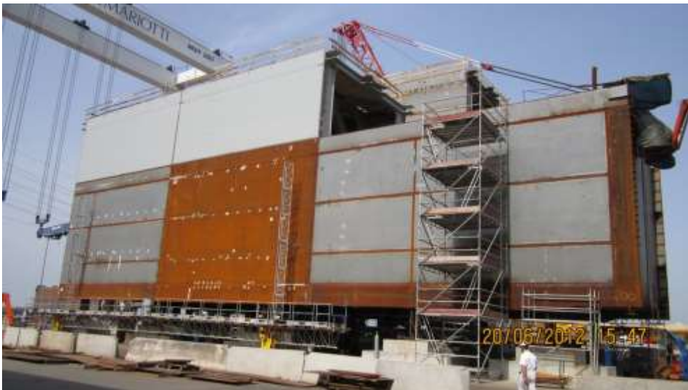
Sopra – Paratoie costruite da Cimolai
